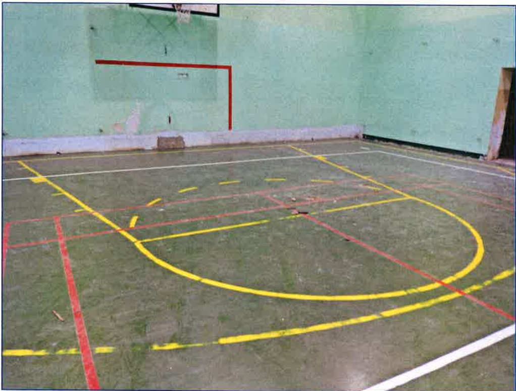
SALA GIMNASTYCZNA PO POWODZI 09 2024 r
